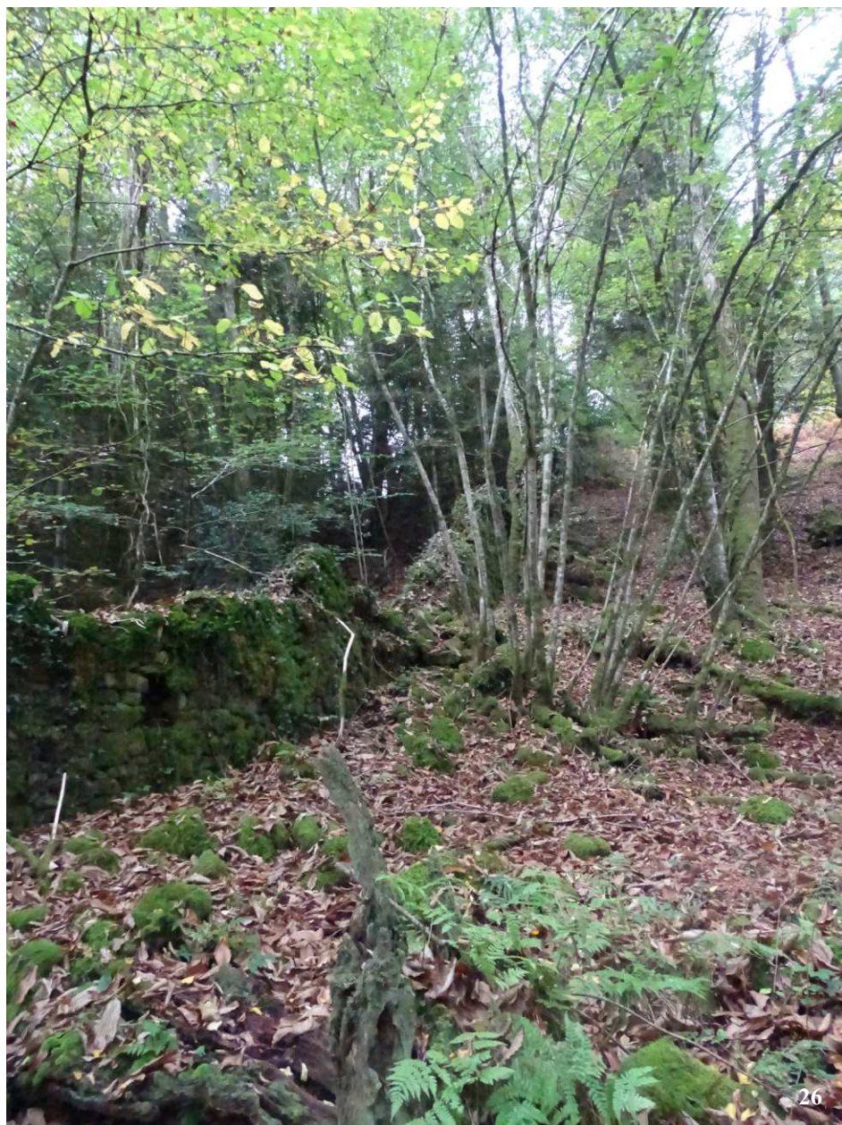
Le mur de clôture du parc en limite de la carrière, sur le versant nord du vallon de Kerbiler
