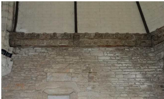
Chœur de l'église, détail du mur nord et de la charpente aux sablières et corniches sculptées
